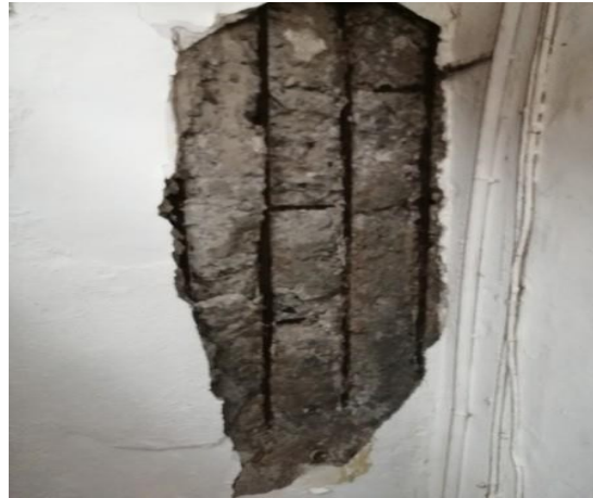
Fig: 12 Damaged Slab
