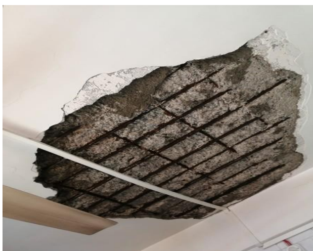
Fig: 11 Damaged Slab
